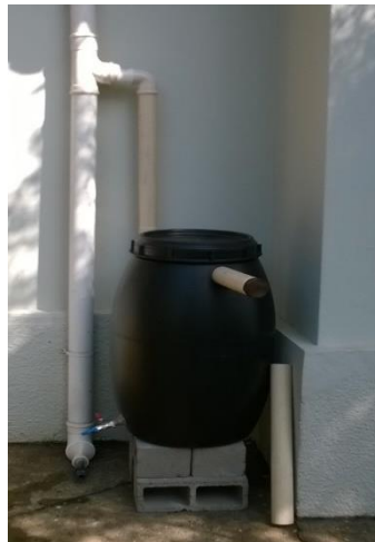
FIGURA 3 – Coletor de água de chuva
