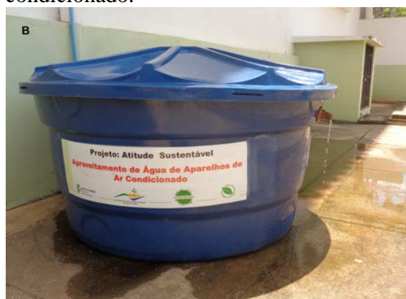
Figura 4B – Captação de água de ar condicionado.
