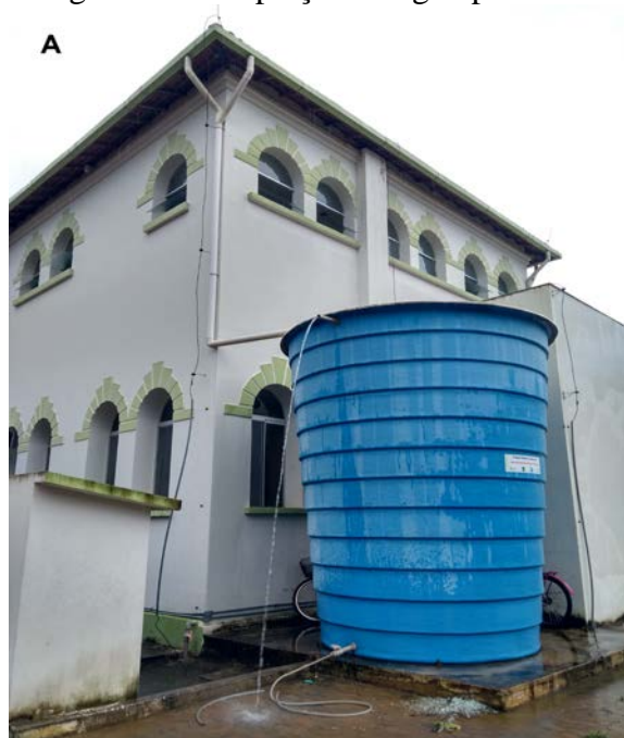
Figura 4A – Captação de água pluvial.
