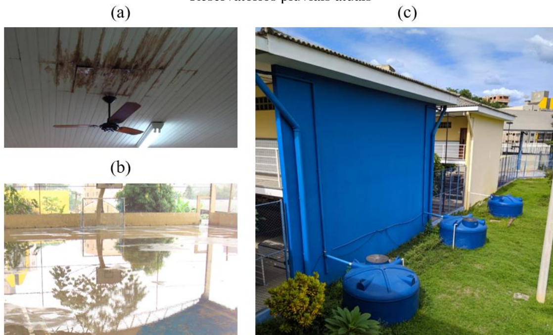
Figura 6: (a) Mofa causado pelas chuvas de 2008 (b) Alagamento da quadra em 2008 (c) Reservatórios pluviais atuais
