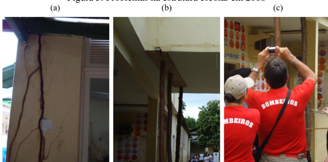
Figura 3: Problemas na estrutura escolar em 2008
