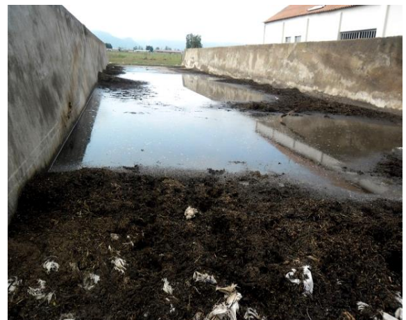
Figura 5: Silo Bunker vazio e em más condições de higiene na Aldeia 1.
