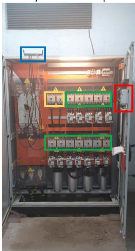
Figura 6: Disposição dos equipamentos de medição e banco de capacitores
